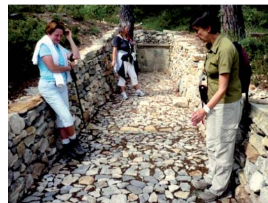
Caromb, ENS du Paty : ancienne fontaine du site pastoral, réhabilités par le CFPPA de Carpentras-Serres
